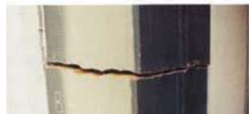
兵庫県南部地震における鋼構造建築の被害 (上は梁端の破断、下は厚肉柱の脆性破壊) Brittle Fracture in Steel Members under Kobe Earthquake
