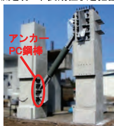
アンカーPC鋼棒の緊張力長期計測
