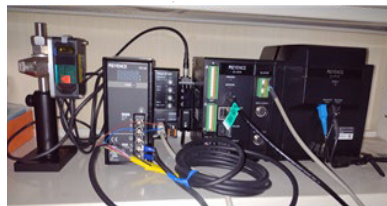
図1 O社の変位計の追加による計測器の整備
