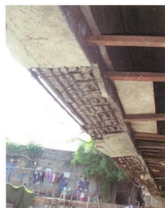
横補強筋が腐食破断した RC 橋
