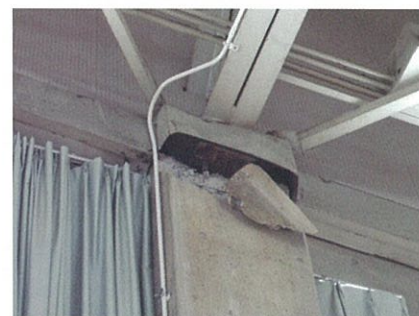
写真2 定着部でのコンクリートの破壊
