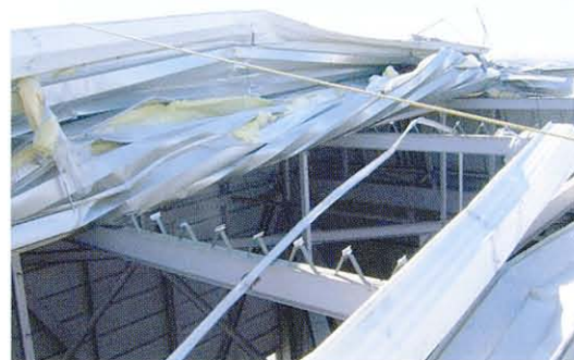
台風で発生した屋根葺き材の飛散事故例
