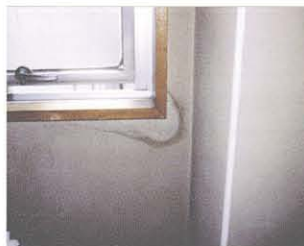
窓まわりからの漏水 (普通の住宅ではよく見られる)
