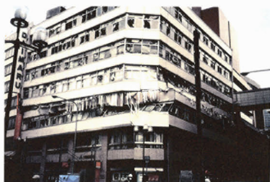
写真1 ねじれ層崩壊した鉄筋コンクリート造建物
